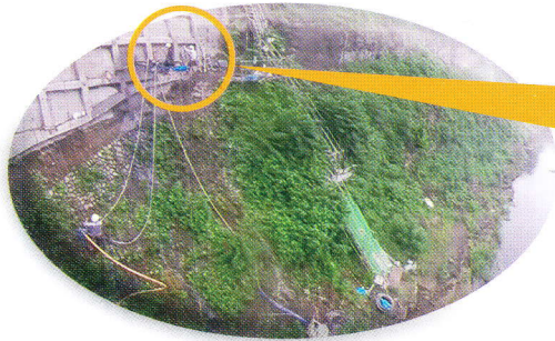
河川上部での施工事例 河川20m上部での排水ボーリング施工。
